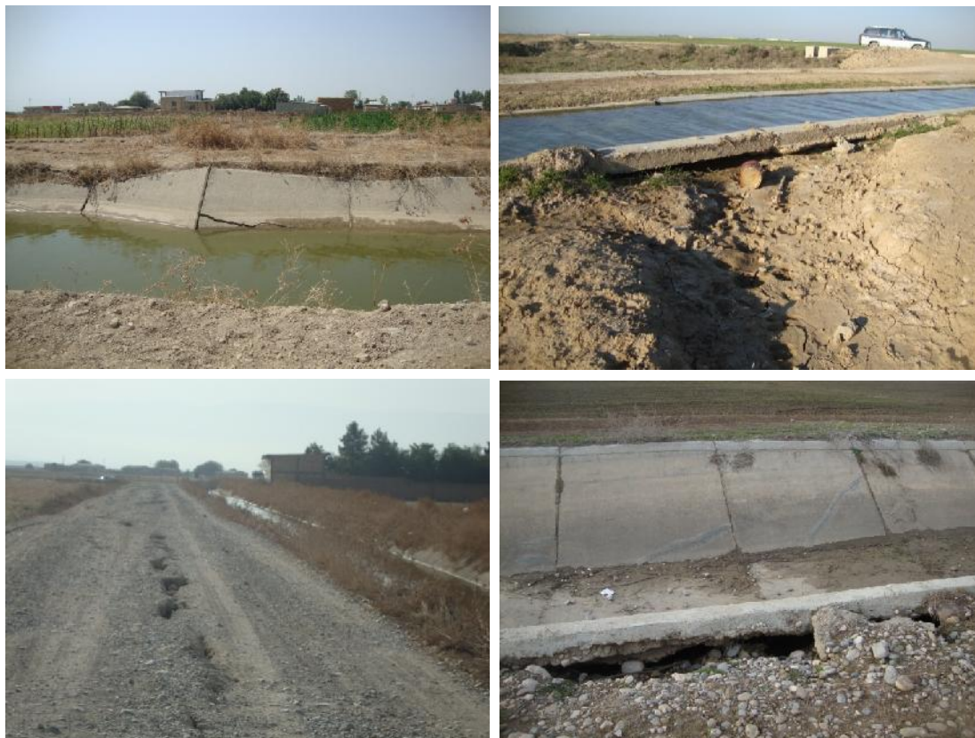
شکل ۴: نشست بستر کانال بدلیل کیفیت نامناسب خاک و عدم آب بندی پشت گوشواره پانل های پوششی.
